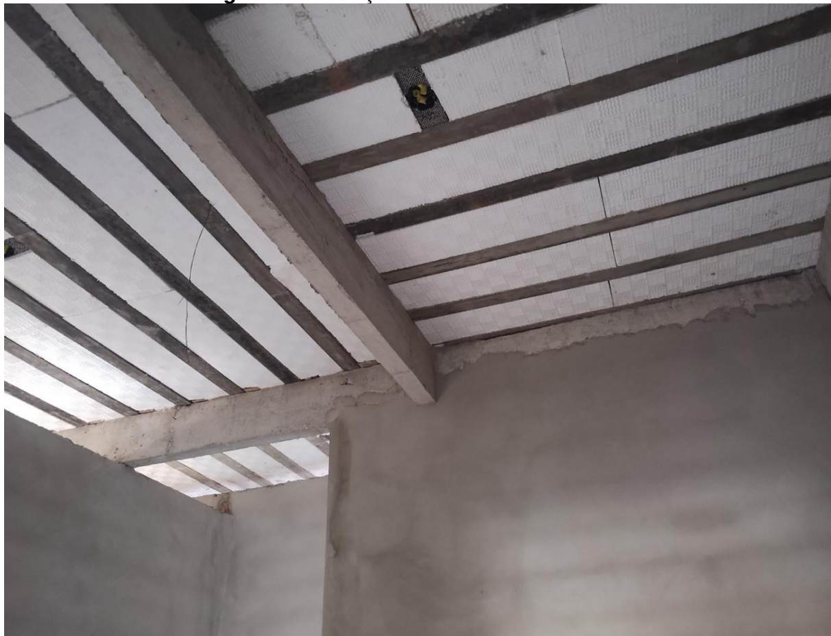
Figura 1 – Situação atual do teto da creche
