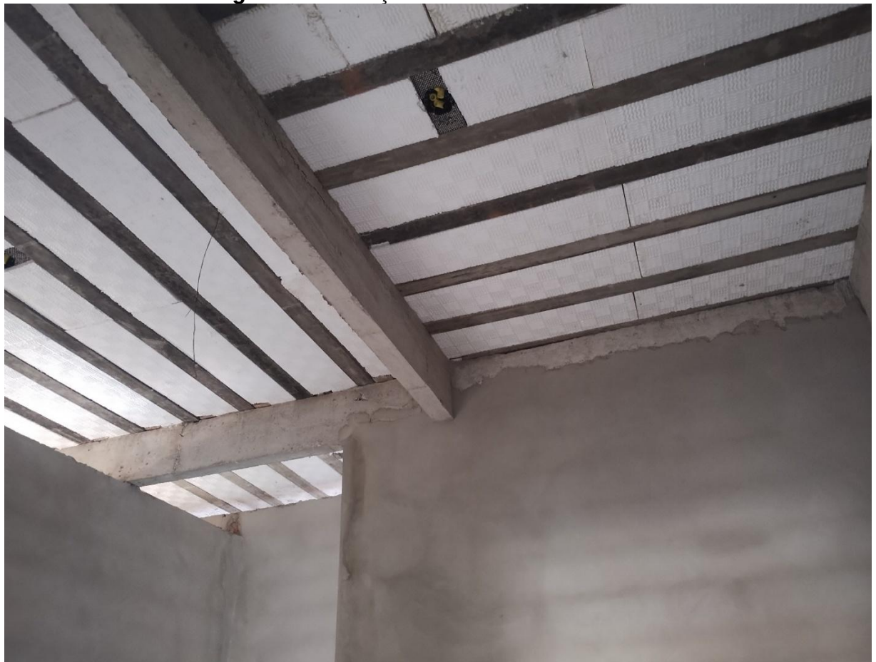
Figura 1 – Situação atual do teto da creche
